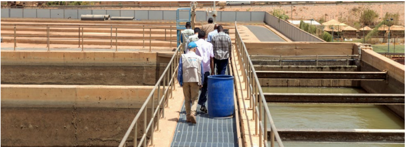
L'usine soutenue par l'UNICEF fournit de l'eau potable à plus d'un million de personnes, au Soudan. © UNICEF/UNI779677/Ahmed Mohamd
